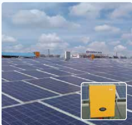
• Rudong, China 1.1MW
