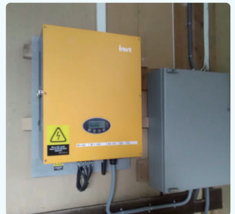
Klavenesveien, Norway 15KW
